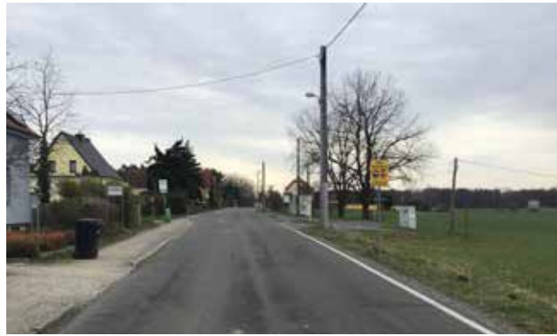
Derzeitiger Straßenzustand im Ortsteil Hufen
