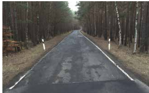
Bauende fertig gestellter 1. BA und Schäden im geplanten 2. BA
