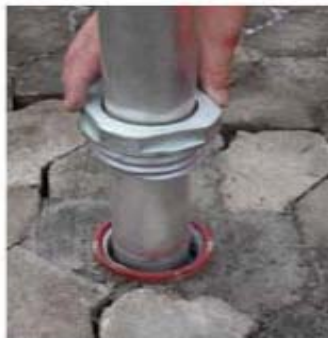
Bodenhülse in Pflaster
