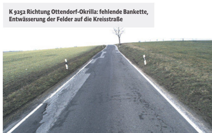
K 9252 Richtung Ottendorf-Okrilla: Straßenschäden und zu enge Straßenradien
