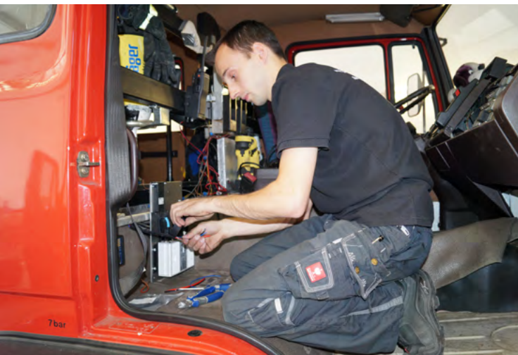
Ein Mitarbeiter der Firma Seltronik Nachrichtentechnik GmbH aus Cottbus baut ein Fahrzeugfunkgerät in ein Tanklöschfahrzeug der FFW Weißenberg ein
