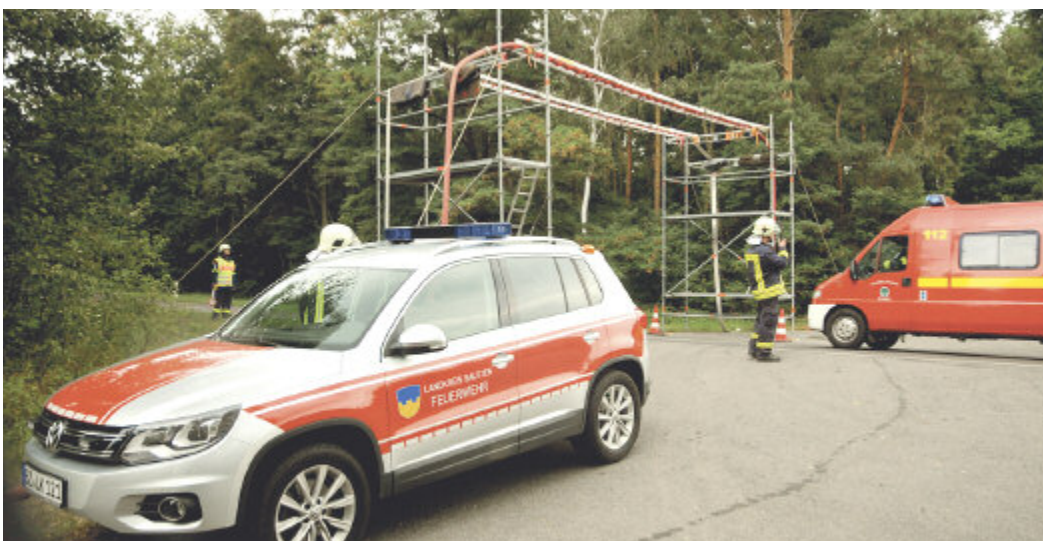
In Zusammenarbeit mit dem Technischen Hilfswerk (THW) errichtete die Feuerwehr über die S 94 eine Schlauchbrücke. Dadurch konnte das Löschwasser vom Teufelsbruch bis zum Übungsgeländes gepumpt werden.
